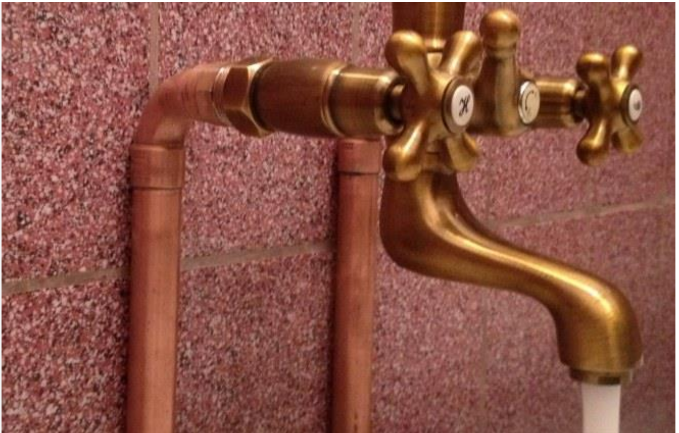
Эстетический вид сантехнических медных труб
